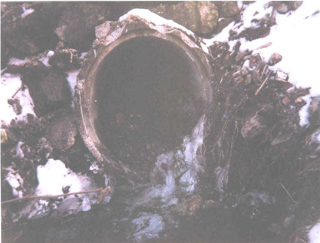
Foto 4 - Sovralluvionamento all'uscita di un tombotto sulla S.P. 67
