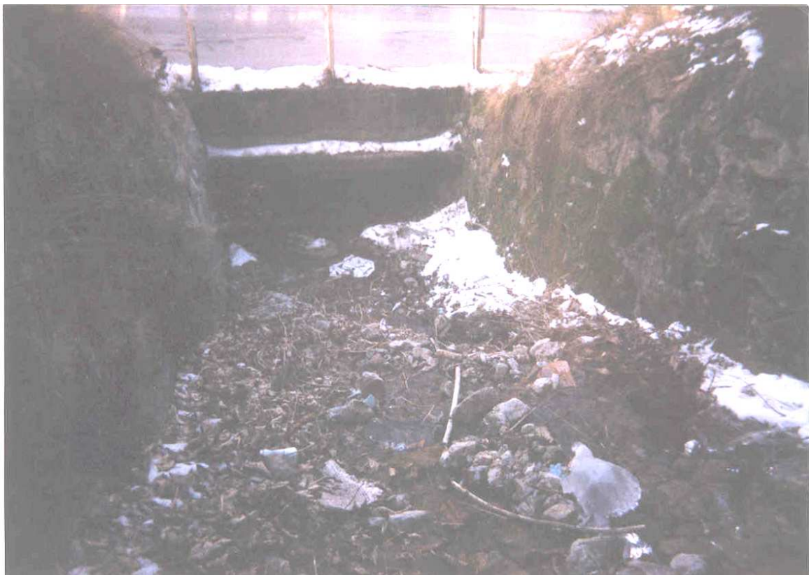
Foto 2 - Tombotto che attraversa la S.P. 66 con forte sovralluvionamento.
